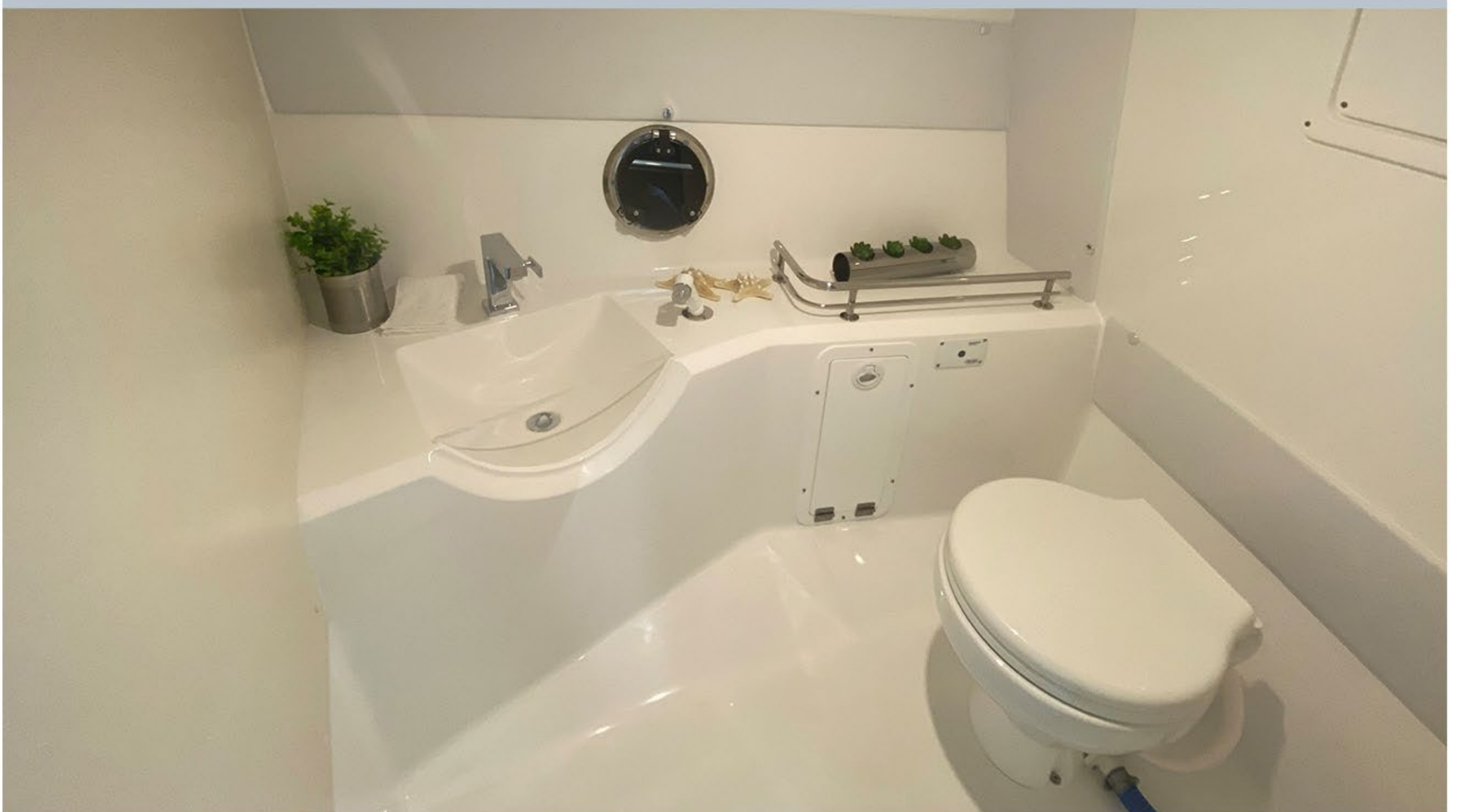
BANHEIRO COM WC ELÉTRICO
